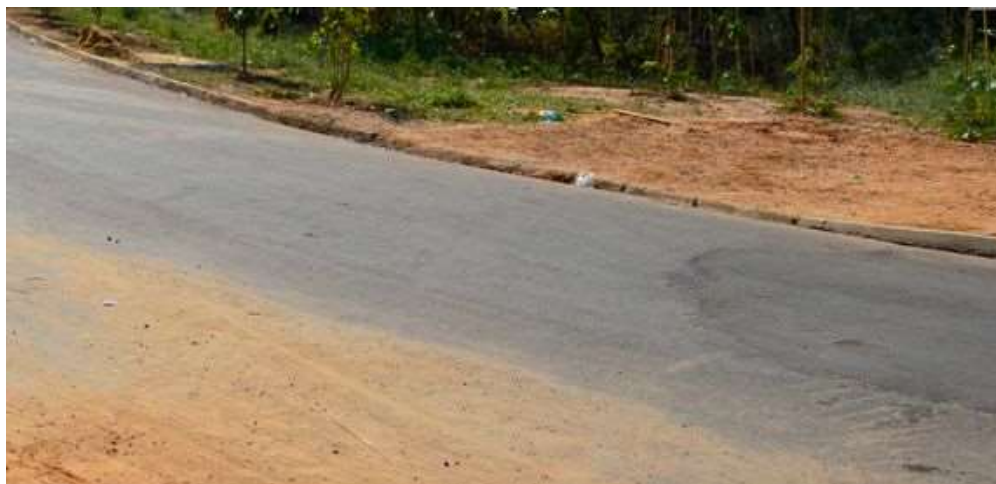
Fotografia 11 - Depósito de solo em rua perpendicular ao perfil da vertente
