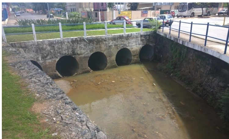
Foto 5 - Retificação, dimensionamento inadequado de tubulações e alto grau de impermeabilização em setor da baixa bacia
