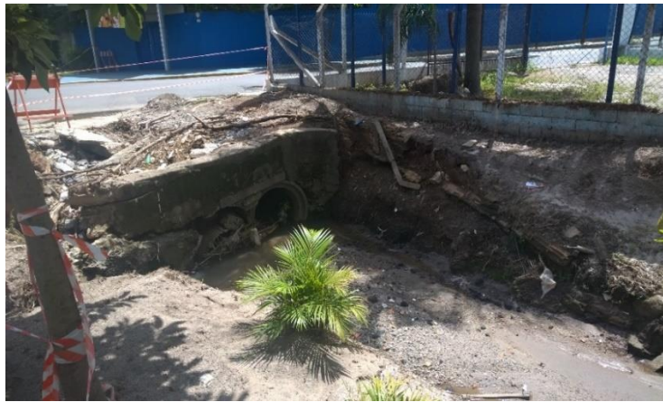
Foto 3- Abatimento de calçada sobre tubulação entupida do córrego da Figueira, um afluente da margem esquerda do Ribeirão Itapetinga
