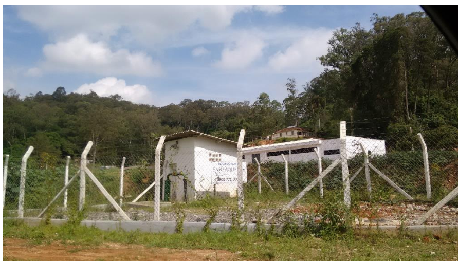
Figura 6. Poço subterrâneo do Horto que responde por 7% do sistema público de abastecimento de água do município de Mairinque, Estado de São Paulo, Brasil.
