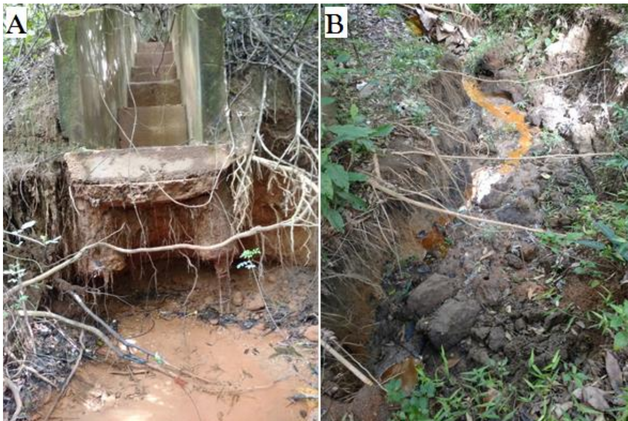
Figura 14. Escada hidráulica desagando em cima da nascente (A) e córrego (B).
