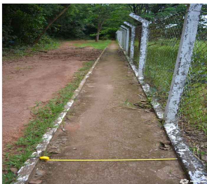
FIGURA 24 – Pista de Caminhada com largura inferior a 1,0 m
