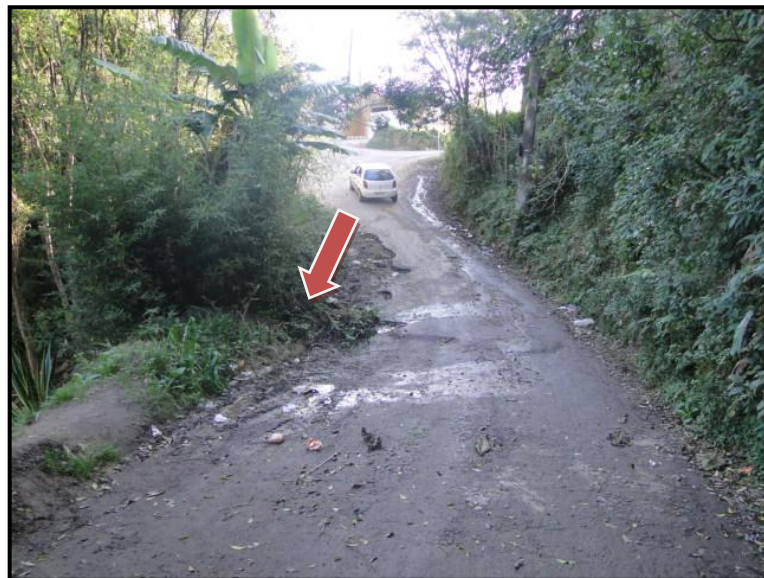
Figura 27 – Escoamento de esgoto sobre a via, e próxima a nascente à esquerda da via
