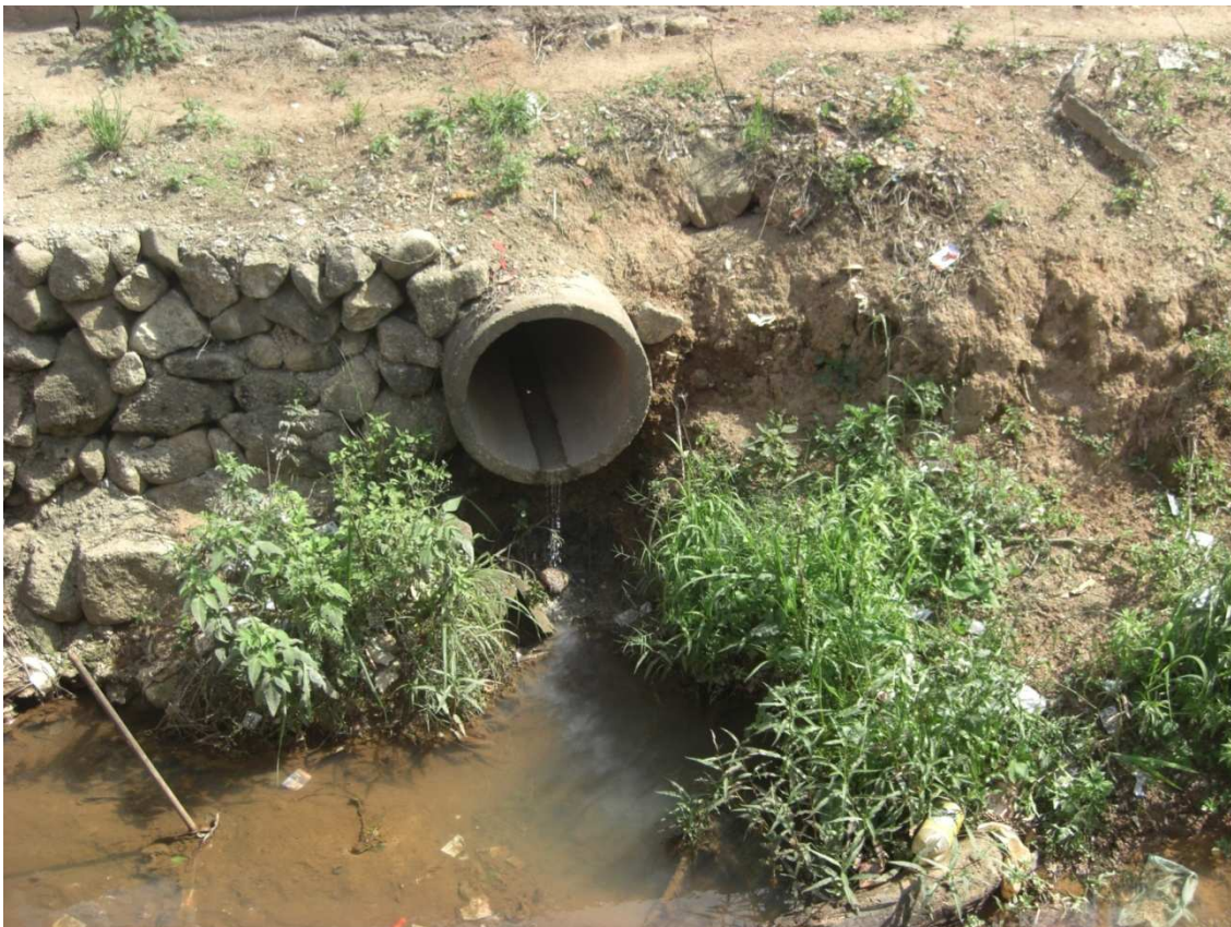
Foto 11: Setor da média bacia. Indicação de efluente de esgoto doméstico sendo lançado no corpo hídrico. (Autor: ONG SOS Itupararanga, 2012).
